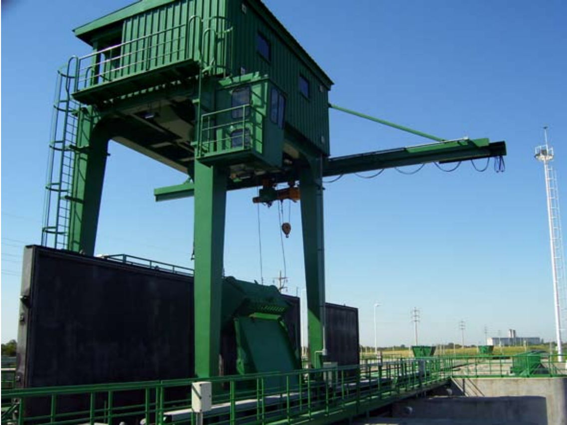
Pórtico para izaje de compuertas, rejas y limpia rejas. Estación de Bombeo Río Negro Barranqueras. Provincia de Chaco.
